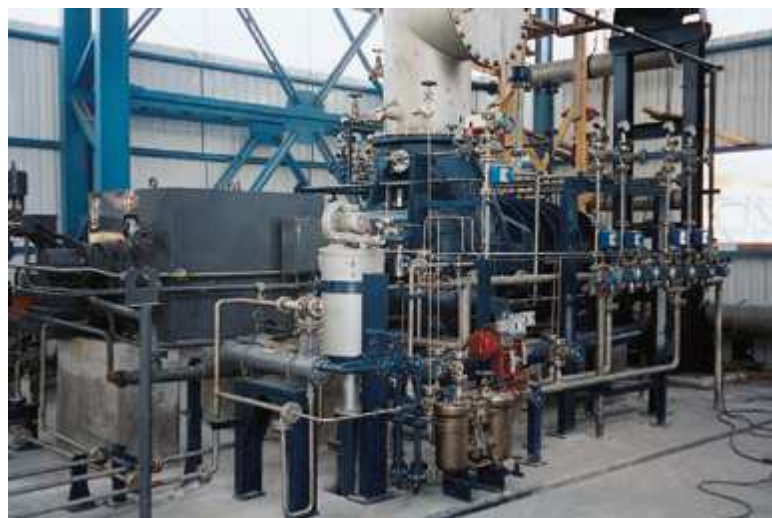
Soda Sanayi, г. Мерсин (Турция), установка сжатия отходящих газов печи обжига известняка VRO 836 L, объем всасывания 45 000 м³/ч, сжатие в диапазоне 0,85 - 3,5 бар (абс.). Гидроизолированное лабиринтное уплотнение с графитовыми кольцами.
