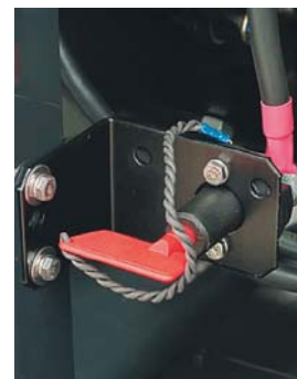
Выключатель аккумуляторной батареи
